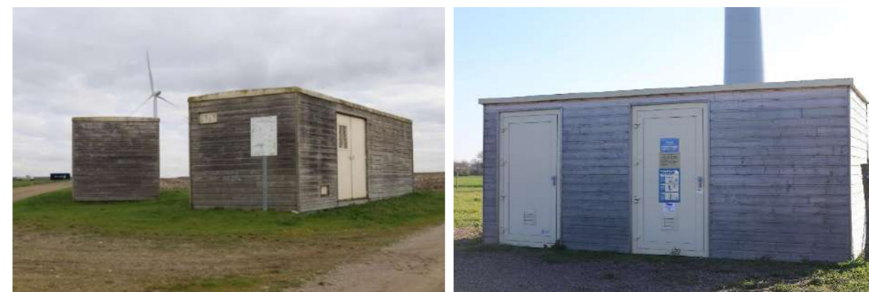
Photo 8 : Exemples de poste de livraison électrique
